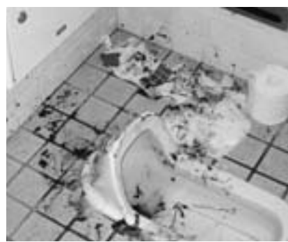
大便器のボヤ火災
