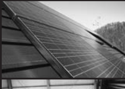
自宅屋根に設置しているソーラーパネル
